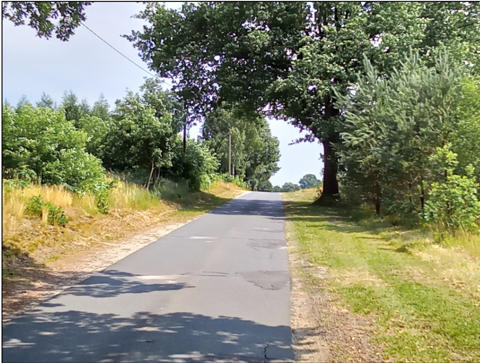
Abb. 4.1 Blick auf die Kuppe, Zustand der Straße Sonnenberg (Blickrichtung Osten)
